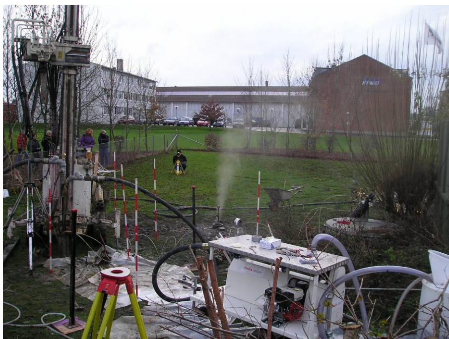
Figur 6.9 Opskydning af gas og vand ved T5 under frakturering fra PF2
