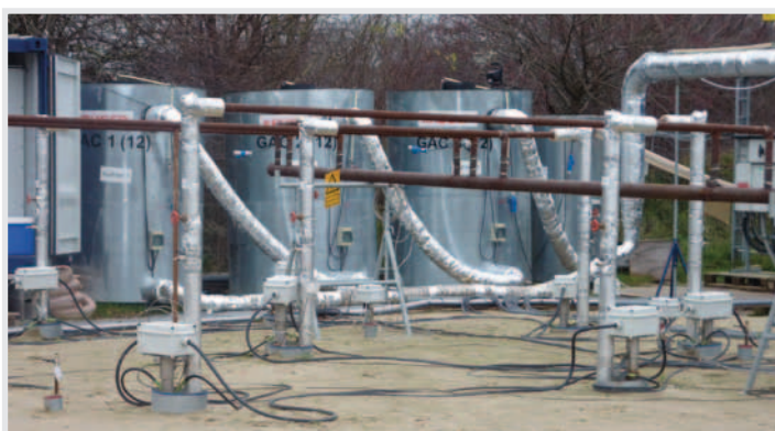
Anlæg til In Situ Thermal Desorption (ISTD). Jorden varmes op og forureningen suges op, hvorefter den fjernes fra gas og grundvand i aktivt kulfiltre.
